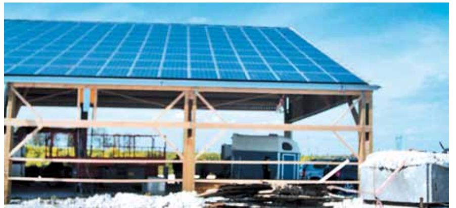
Bâtiment à ossature bois, 900 mètres carrés de panneaux photovoltaïques.
